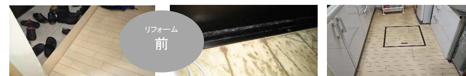
玄関、水回り、日のあたる場所。床材がこのように劣化していました。
